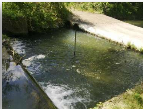
Photo 81 : déversoir bras des moines et route busée effondrée
