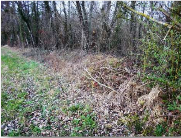
Photo 62: profil du bourrelet de curage en bordure du Betz à l'aval du Bignon/M
