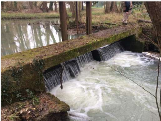
Photo 96 : vannage avant la confluence
